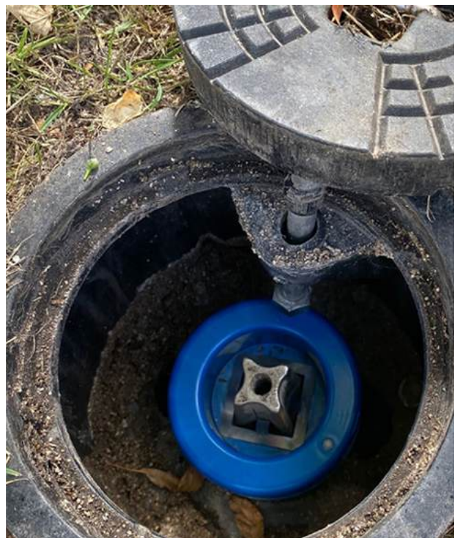
VIDI Positioner installato in un chiusino stradale in plastica.
