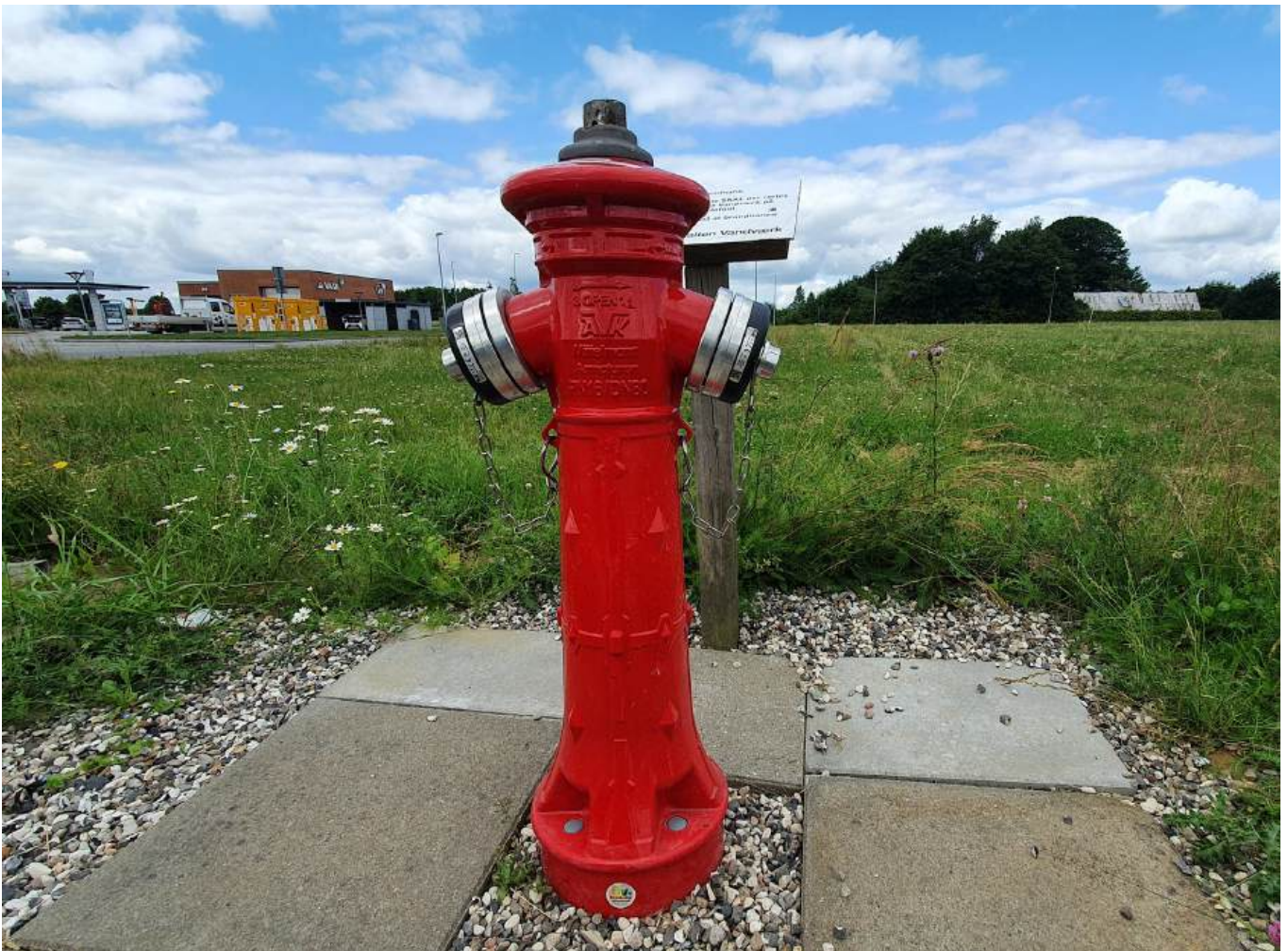
Idrante con VIDI Cap installato. L'uso di un idrante influisce sulla pressione in un'area. Pertanto, è importante che il gestore sappia quando viene utilizzato l'idrante per distinguere una caduta di pressione derivante dall'uso regolare o da una rottura di un tubo.
